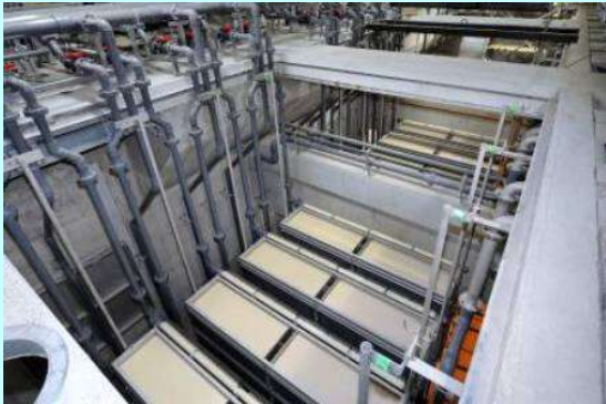
守山水処理センターの膜ろ過設備
